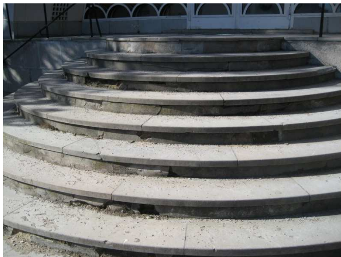
Exempel på skador på befintlig entrétrappa.
