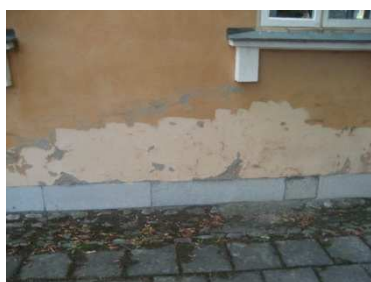
Exempel på putsskada
