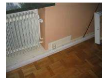
Vägguttag och elkanal i plast
