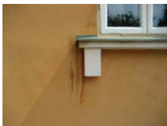
Exempel på missfärgning efter vattenrinning från kopparbleck.
