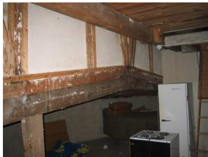
Foto som visar spännstolen av trä med sprickor i underramen.
