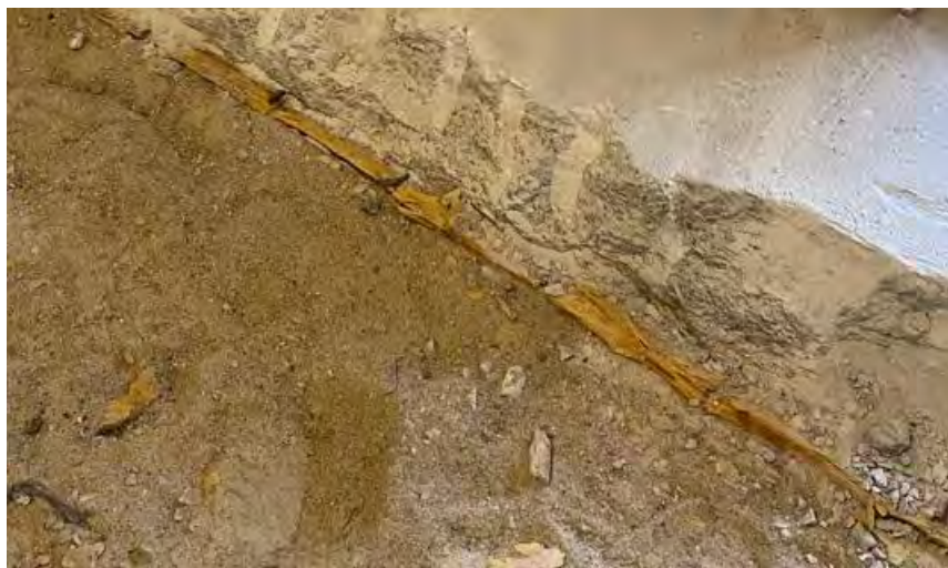
Figur 8 Träregel under betong
