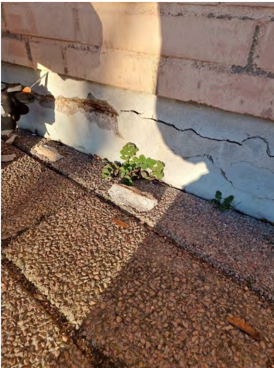
Figur 14 armeringskorrosion och betongspjälkning
