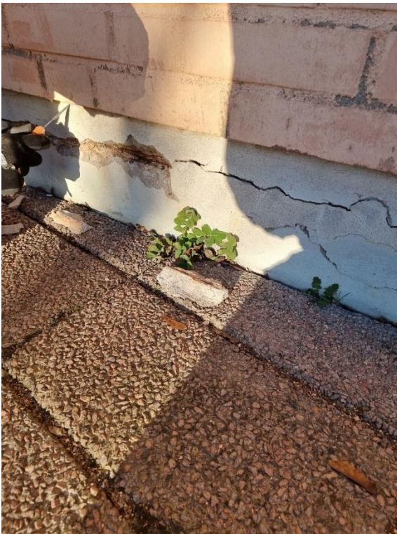
Figur 14 armeringskorrosion och betongspjälkning
