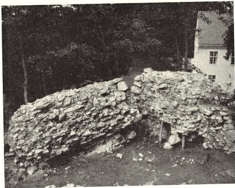
Bild 7. Tornets västra vägg var hårt spolierad och hade dessutom råkat på glid och tippat utåt. Förfallet var långt gånget.
