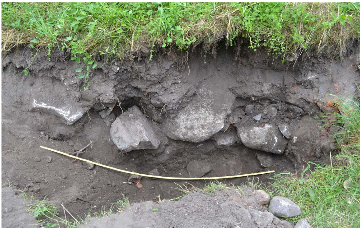
Figur 18. Stenskoneringen A7 sedd i profil efter det att schaktet grävts ned till botten. Foto taget från norr.
