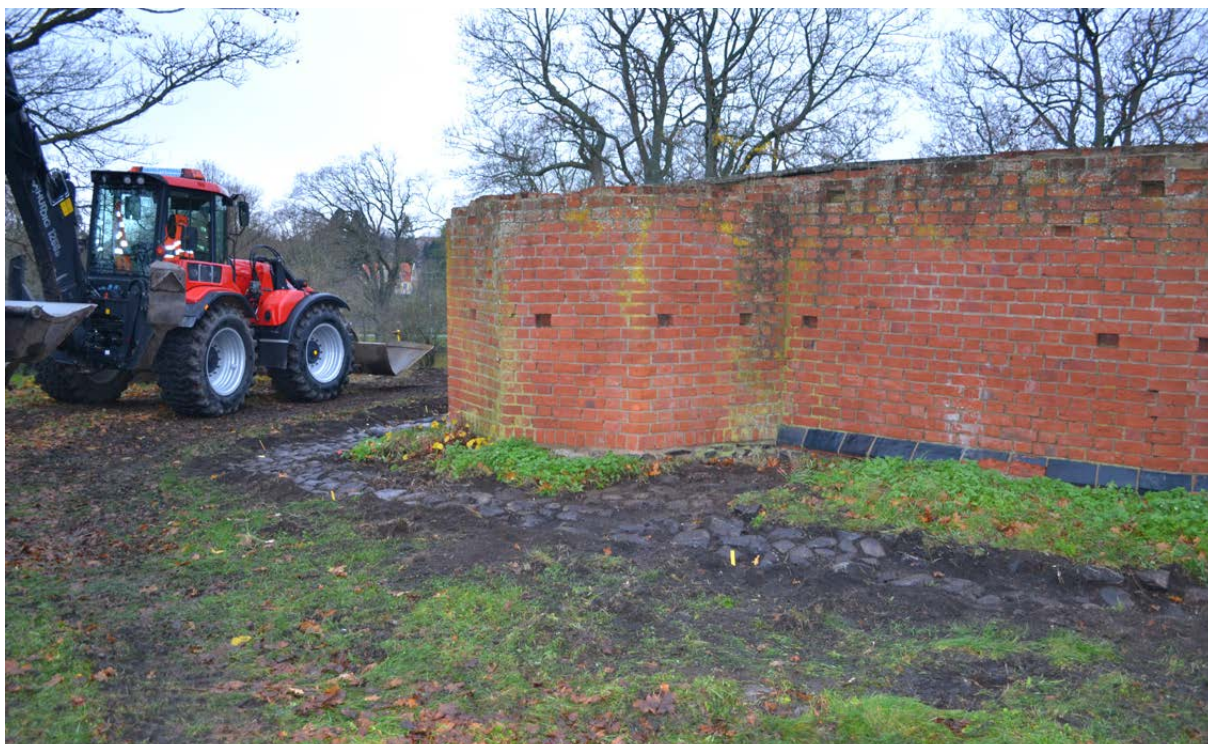
Figur 34. Vissa delar av stenläggningen A16, även utanför den skadade sydvästra delen, bör ha blivit borttagna och återställda vid restaureringen under 1940-talet. På bilden syns ett avsnitt av stenläggningen vid tornets sydöstra del där äldre foton visar att man djupgrävde i samband med restaureringsarbetet. Foto taget från nordöst.
