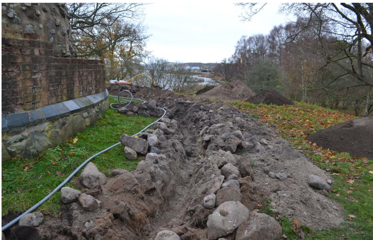
Figur 21. Efter att stenläggningen inom borggården dokumenterats grävde man igenom denna och ned i ett underliggande sättsandslager. Foto från den västra sidan av tornet taget från norr.
